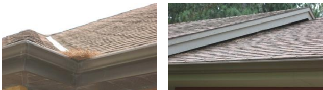
Αριστερά, συσσώρευση πευκοβελόνων στην υδρορροή. Δεξιά, σχετικά καθαρή στέγη.
