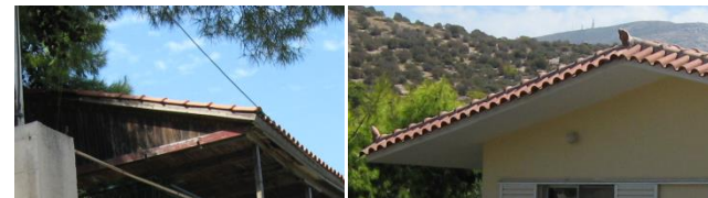
Αντιπαράθεση κεραμικών στεγών. Αριστερά στέγη με ξύλινο υπόβαθρο, εύφλεκτη. Δεξιά, τσιμεντένια, δεν αναφλέγεται. Και στις δύο περιπτώσεις η βλάστηση ακουμπά στις στέγες, γεγονός που αυξάνει τον κίνδυνο από πυρκαγιά.
